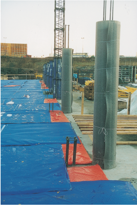
Kuva 14. Hyvin ennakkoon mietitty suojaus-suunnitelma varmistaa valitun lämmitysmenetelmän toimivuuden.
