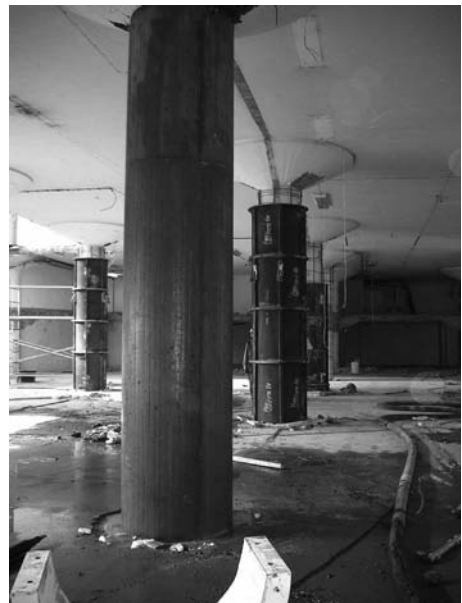
Kuva 7. Vanhojen pilareiden ja sienivahvistusten manttelointia itsetiivistyvällä betonilla. Ahtaat valut ovat erinomaisia IT-betonin käyttökohteita.
