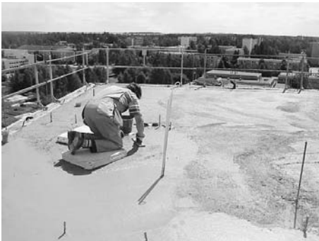
Kuva 3. Tekemällä yläpuolinen laatta nopeasti tiiviiksi estetään veden valuminen alempiin kerroksiin. Hyvin suunnitelluissa ja toteutetuissa kerroksissa rakenteiden kuivuminen alemmissa kerroksissa on jo lähtenyt käyntiin, vaikka ylempiä kerroksia vielä valetaan.
