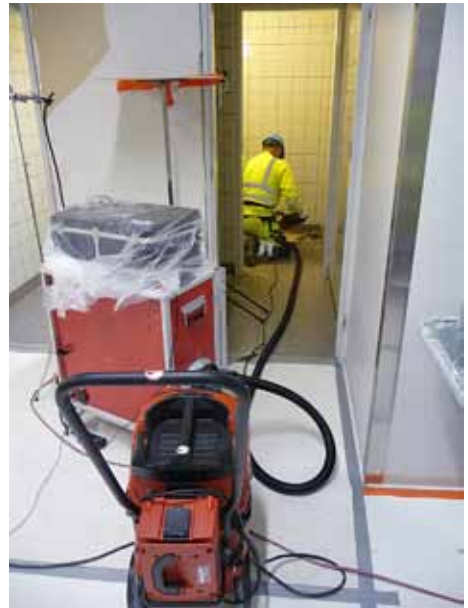
Kuva 5. Lattian piikkausta kohdepoistolla varustetulla piikkausvasaralla: hengittyvän pölyn pitoisuus 5–10 mg/m 3 , alveolijakeisen kvartsin pitoisuus alle raja-arvon (ilman kohdepoistoa pitoisuudet 6–8-kertaisia).
