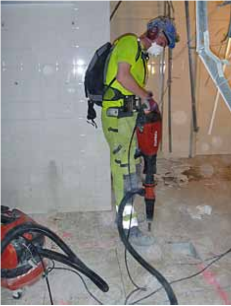
Kuva 6. Kaakeleiden poistoa (piikkausvasarassa kohdepoisto): hengittyvä pöly 10–14 mg/m 3 , alveolijakeinen kvartsi 0,013 mg/m 3 (ilman kohdepoistoa pölypitoisuudet 4–6-kertaisia ja kvartsipitoisuudet n. 10-kertaisia).
